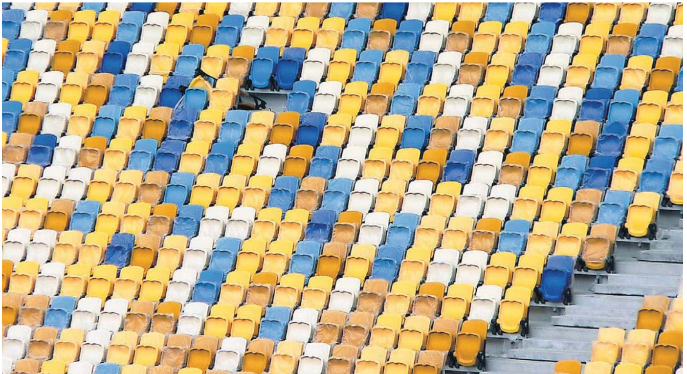
Stadionbau mangelhaft: Die Arena in der westukrainischen Stadt Lwiw wurde erst Ende Oktober unfertig eröffnet.
